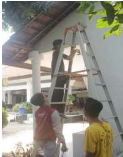
Gambar 40 Hambatan Pemasangan Listrik
